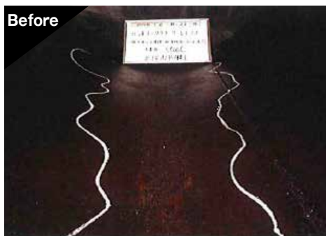
2020年8月22日施工後、地下タンク内腐食状況
