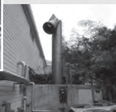
煙突破損状況
